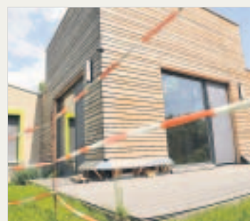
Pfusch: Der Anbau der Krebser Kita ist nicht nutzbar.
